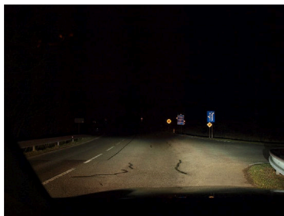
Obrázek 4 – Ukázka špatně viditelného křižovatkového prostoru z důvodu absence vodorovného dopravního značení (prostor je osvětlen potkávácími světlomety osobního automobilu).
